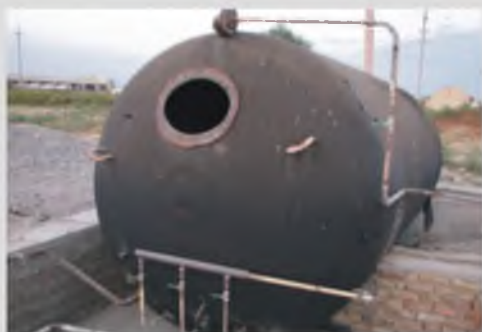
Внешний вид подводящих труб перемешивающего устройства и отопительных труб
