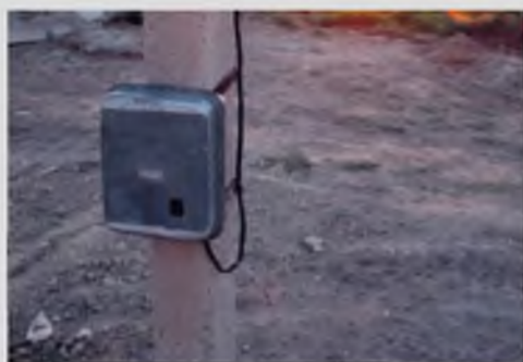
Электрический щит для подачи электроэнергии к БГУ
