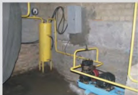
Водяной фильтр и компрессор
