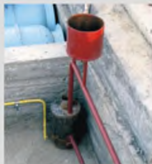
Водяной нагревательный котел и расширительный бачок
